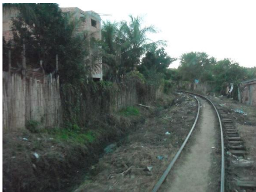
Figura 3.42 – Valeta assoreada Ferrovia Centro Atlântico
