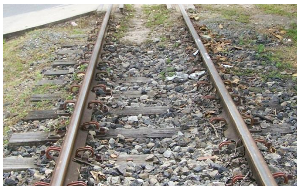
Figura 3.12 - Trecho Simões Filho/ Alagoínhas Detalhe do trilho/dormente/fixação
